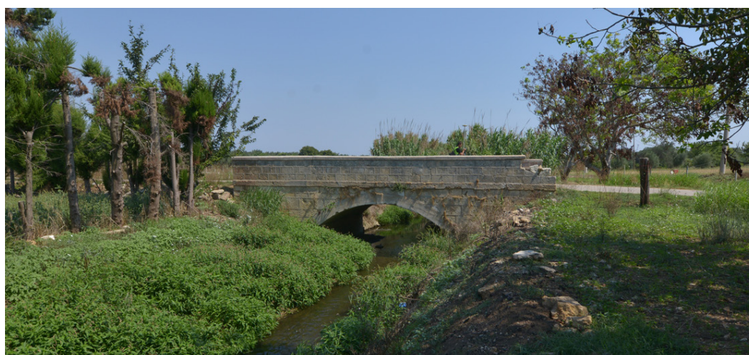
Fig. 34 – Attraversamento BR05500040SL (Brindisi), non adeguatamente dimensionato
