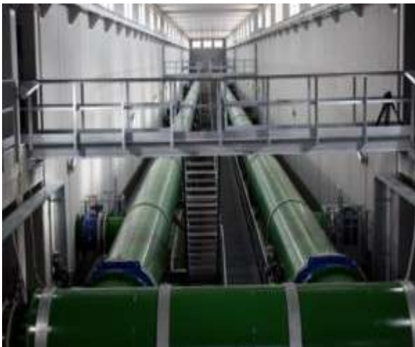
Nuovo serbatoio idrico seminterrato di Marzagaglia
