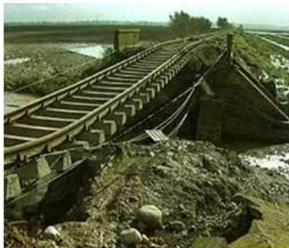
Disesto tratto ferroviario FG-PZ
