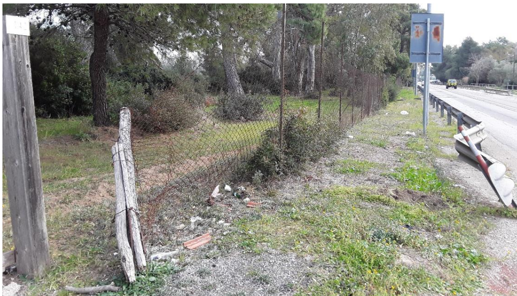
Foto 21 – Rete di recinzione in pessimo stato di conservazione (tratto 17-18 del perimetro del Complesso)
