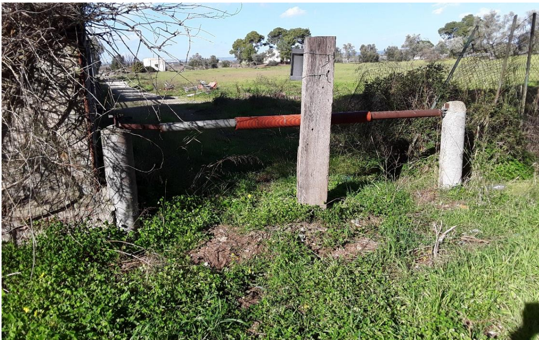
Foto 24 – Sbarra in ferro in pessimo stato di conservazione (tratto 19-20 del perimetro del Complesso)
