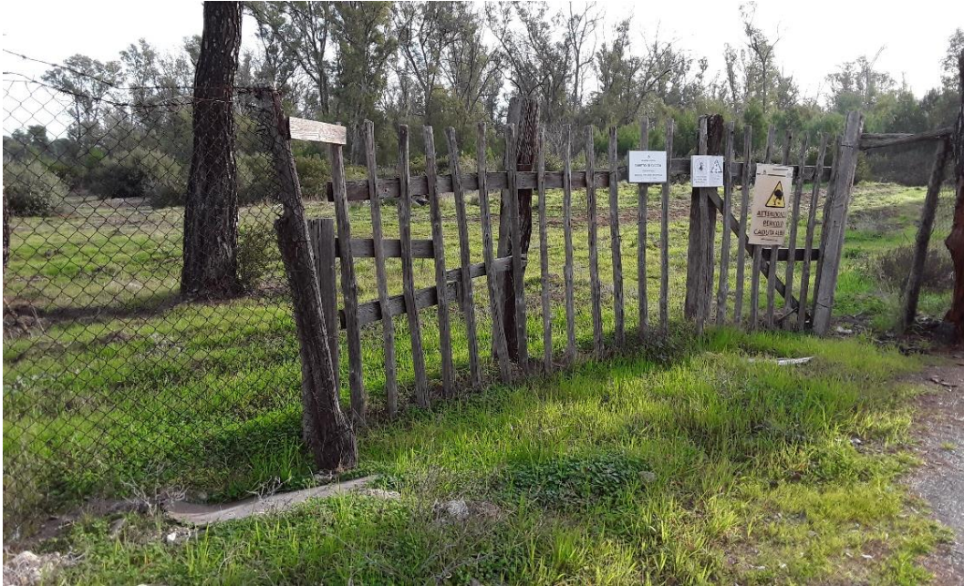
Foto 23 – Cannello in legno in pessimo stato di conservazione (tratto 17-18 del perimetro del Complesso)
