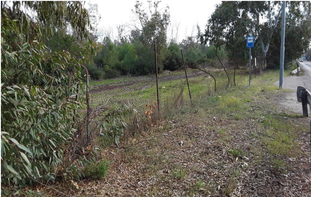
Foto 28 – Tratto di recinzione metallica in pessimo stato di conservazione
